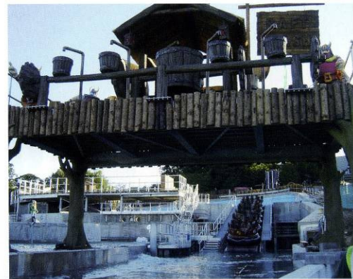
Die schöne Trollwaschanlage täuscht leider nicht darüber hinweg, dass der Beton ringsum unverkleidet ist.
